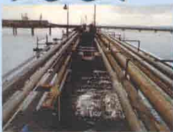
Pontile fuori servizio attesa montaggio nuove travi.
